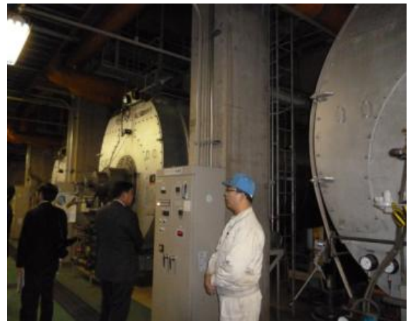
熱源設備 (ボイラー等)
