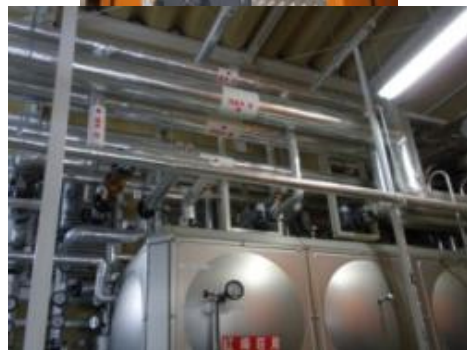
上：生チップ焚きボイラ（900kw） 下：ボイラ施設内配管
