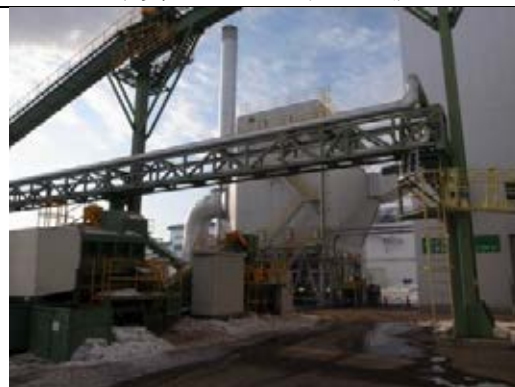
発電用ボイラ
